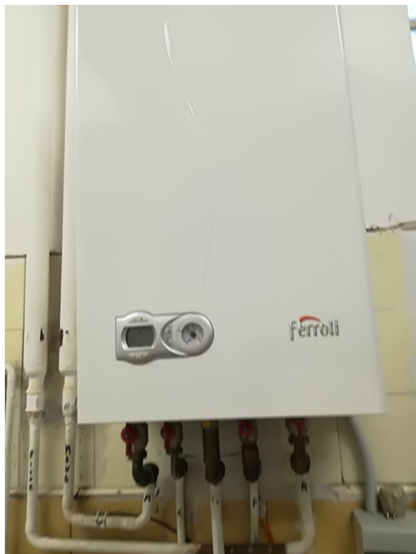
Figura 4.9 - Particolare della caldaia 1
