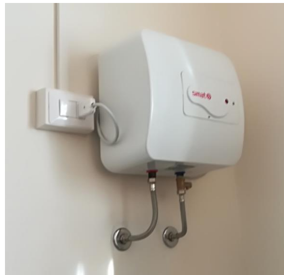
Figura 4.11 - Particolare di un boiler elettrico per la produzione di acqua calda sanitaria
