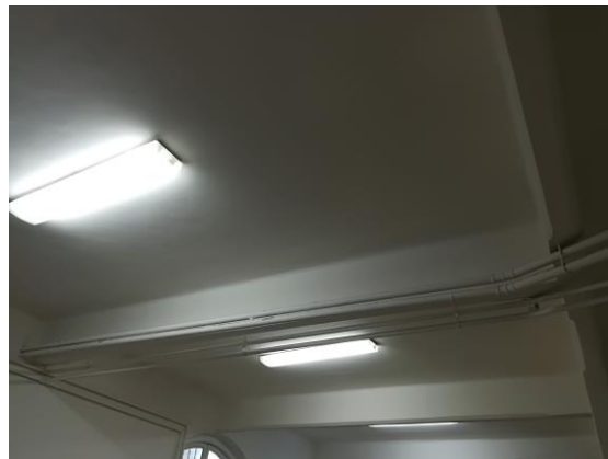
Figura 4.12 - Particolare dei corpi illuminanti ubicati nelle zone di circolazione interna
