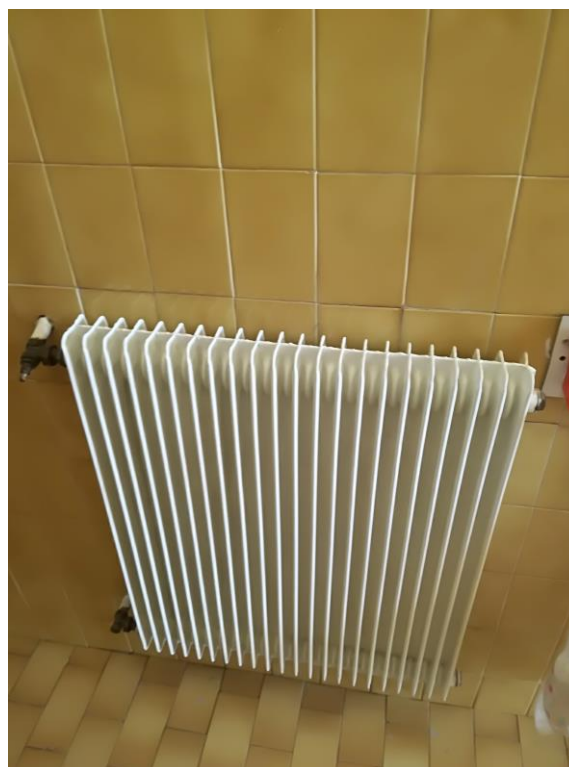
Figura 4.5 - Particolare dei radiatori installati sulle pareti esterne degli ambienti
