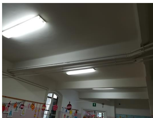
Figura 8.5 - Particolare di una lampada fluorescente attualmente installata
