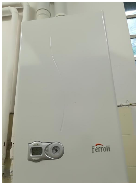
Figura 4.10 - Particolare della caldaia 2
