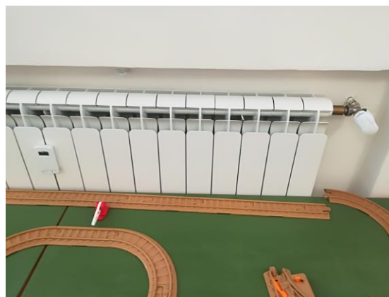
Figura 4.7 - Particolare delle valvole termostatiche
